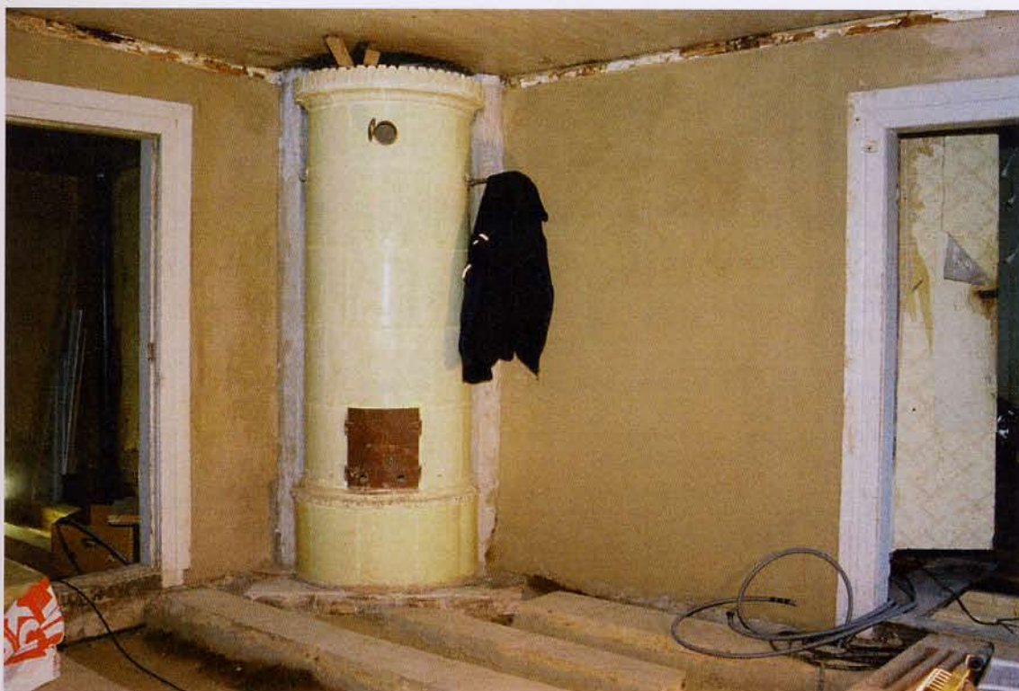
Kakelugnen är färdigmurad, väggarna lerklinade och bjälklagets trossbottenbräder täckta med ett lager lera i rum 106, 2005-10-07. Neg.nr: 05/122:31A. Foto: Ulf Larsson.
