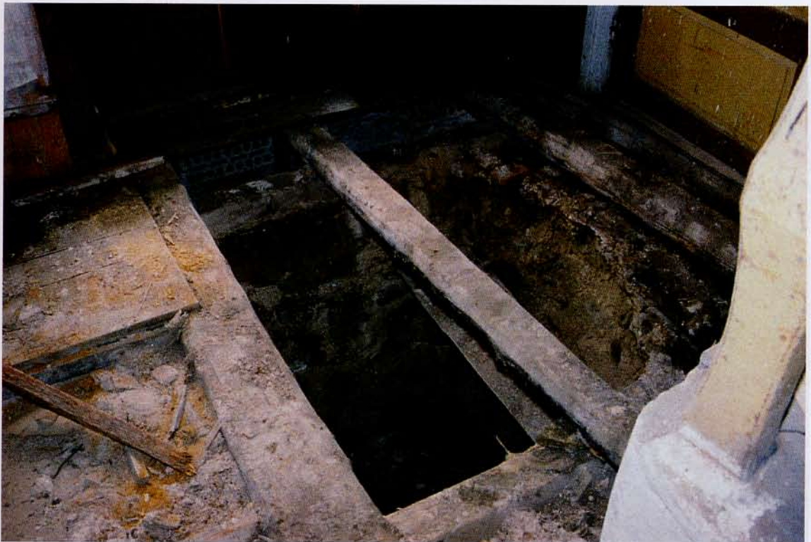
I rum 104, kök, upptäcktes ett källarutrymme under golvbräderna, 2005-05-26. Lägg även märke till grunden, som i sin tid murats om med betonghålsten ("gråsuggor"). Neg.nr: 05/86:4A. Foto: Ulf Larsson.
