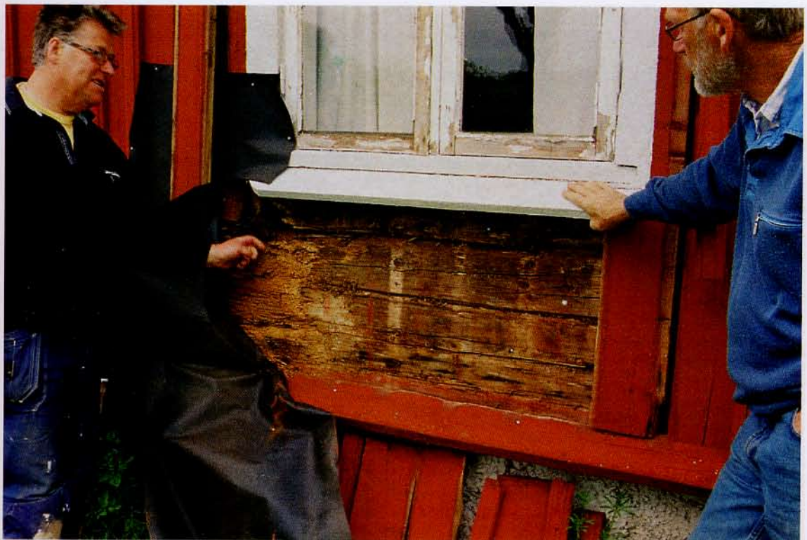
Anders Sahlström och Olle Dagobert studerar den rötskadade timmerstommen under södra fasadens östra fönster, 2005-05-26. Neg.nr: 05/86:10A. Foto: Ulf Larsson.
