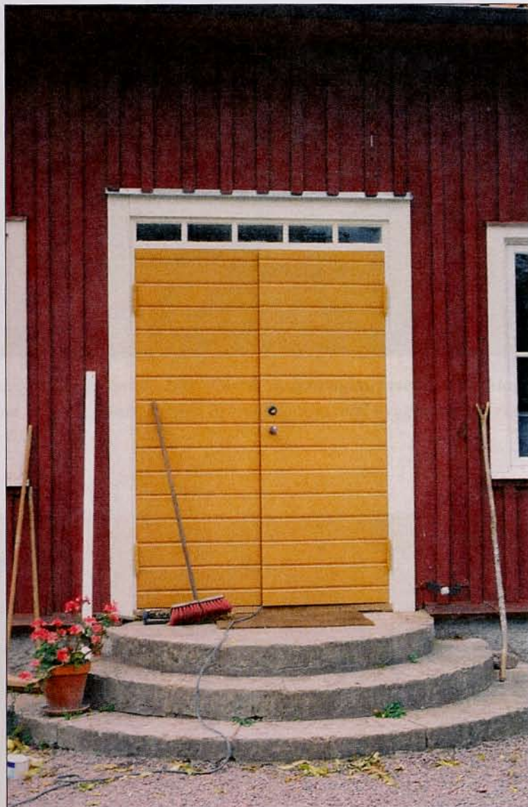
Huvudbyggnadens entréparti efter färdigställandet, 2003-09-25. Dörrpartiet har utvidgats till ursprunglig bredd och nya pardörrar med överljus har tillverkats. Neg. nr 03/362:2.
