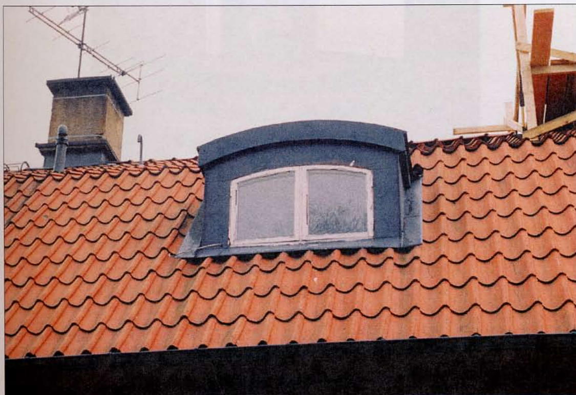
Takkupan på huvudbyggnadens västra takfall före ombyggnaden, 2003-01-20. Vy från väster. Neg. nr 03/10:29.
