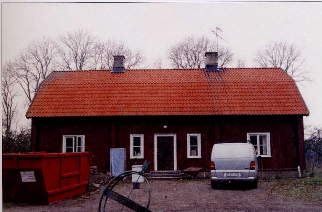
Torps huvudbyggnad efter att renoveringen påbörjats, 2002-11-07. Skorstenarna fick muras om helt till under nock och hållarna bytas ut. Notera även entrédörren. Vy från öster. Neg. nr 03/2:12.
