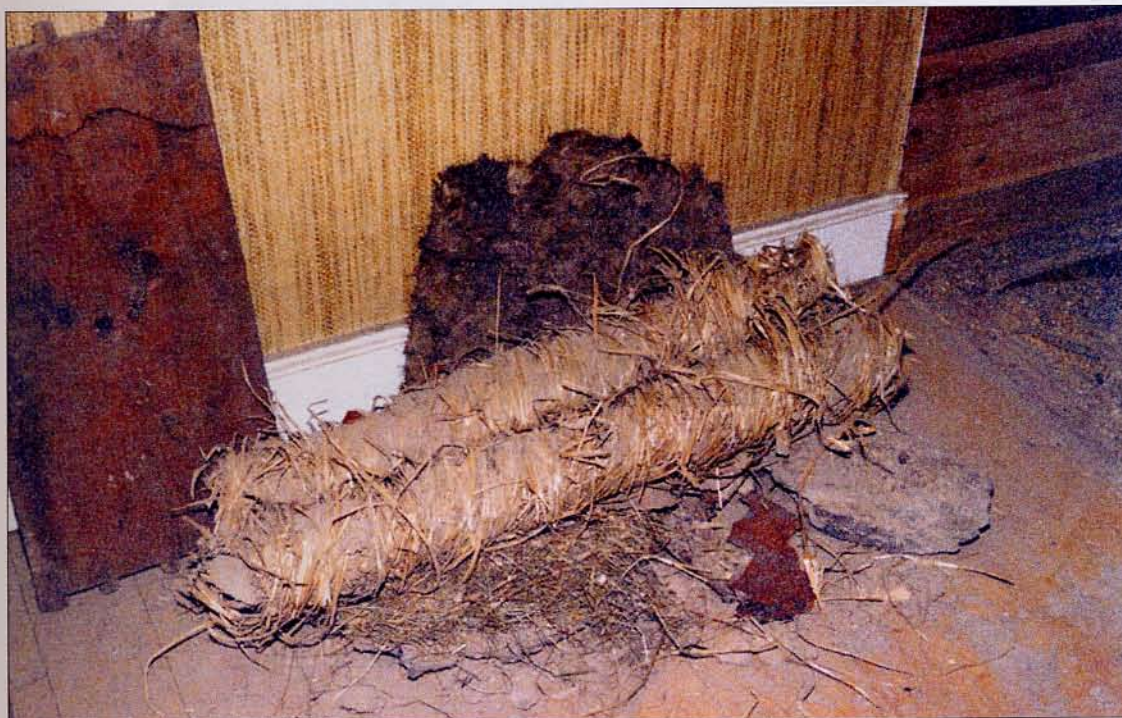
"Klebbestakar" från övervåningens innerväggar, framkomna vid håltagning för garderob. 2002-11-07. Neg.nr 03/2:8.
